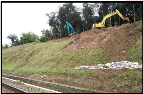
Gambar V.1 Kondisi Lereng Pasca Terjadinya Longsor
