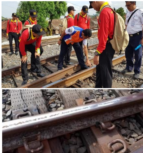
Gambar 1. Kerusakan Pada Permukaan Jalan Rel Kereta Api di Batu Raja
